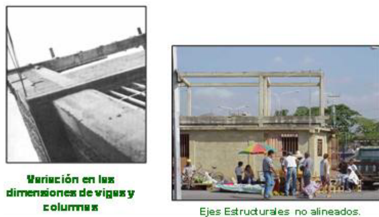
Foto 4. Falta de Claridad en las Formas y Sistema Estructural Desorganizado.
