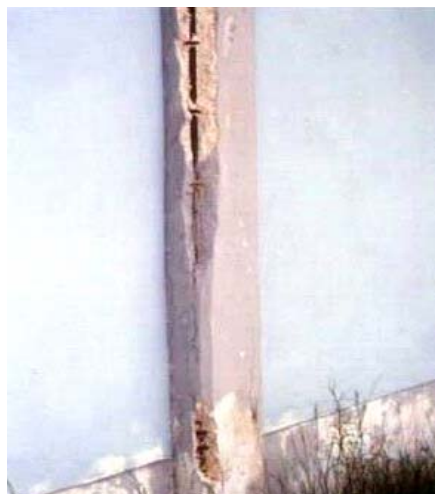
Figura 1 Condições típicas de corrosão em colunas antes de ser reparadas.
